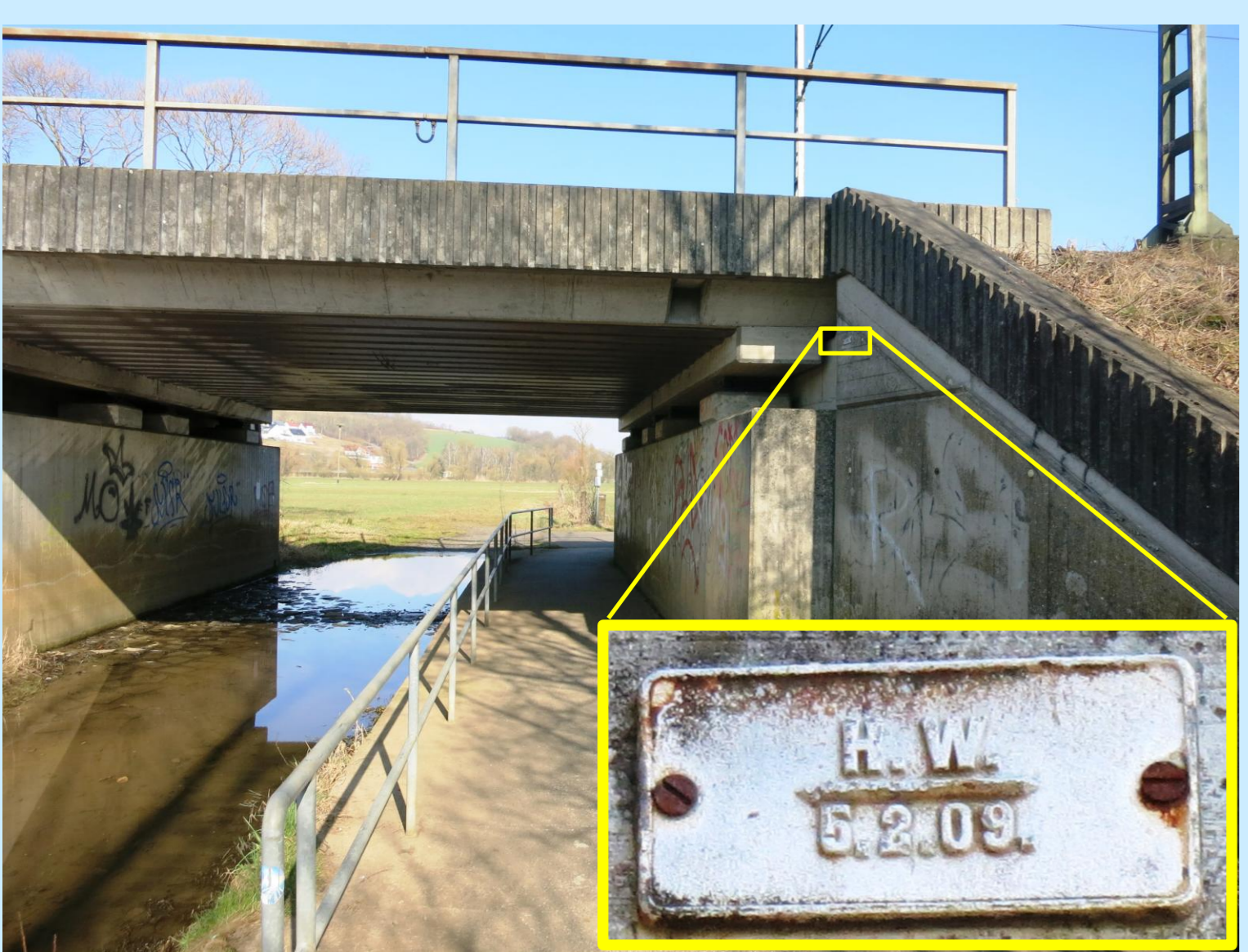
5.2.09 Hochwassermarken an der Eisenbahnbrücke Kreuzung zum Radweg R3
